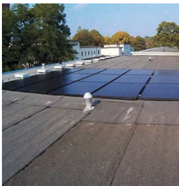
15. Denkmalrechtlich erlaubte PV-Anlage auf dem historischen Dach eines Hauses in der Einschornsteinsiedlung in Duisburg-Neudorf. Foto: UDB Duisburg.
