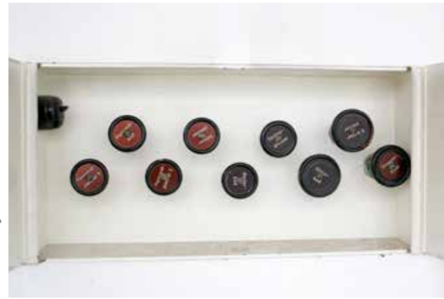
Viersen, Haus Kaiser 2, Heizungsregulierung
