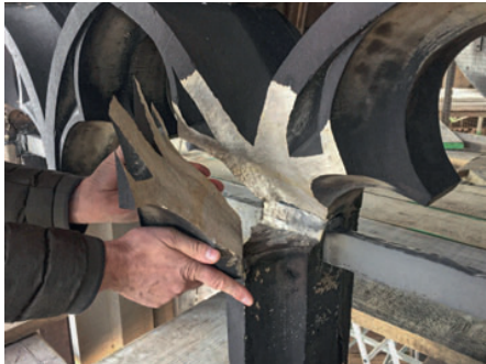
ABBILDUNG 2: REPARATUR VON AUSBRÜCHEN AM NÖRDLICHEN MAßWERK DES TURMOBERGESCHOSSES MITTELS VIERUNGEN AUS SANDSTEIN (FOTO: FIRMA PÄTZKE, PADERBORN)
