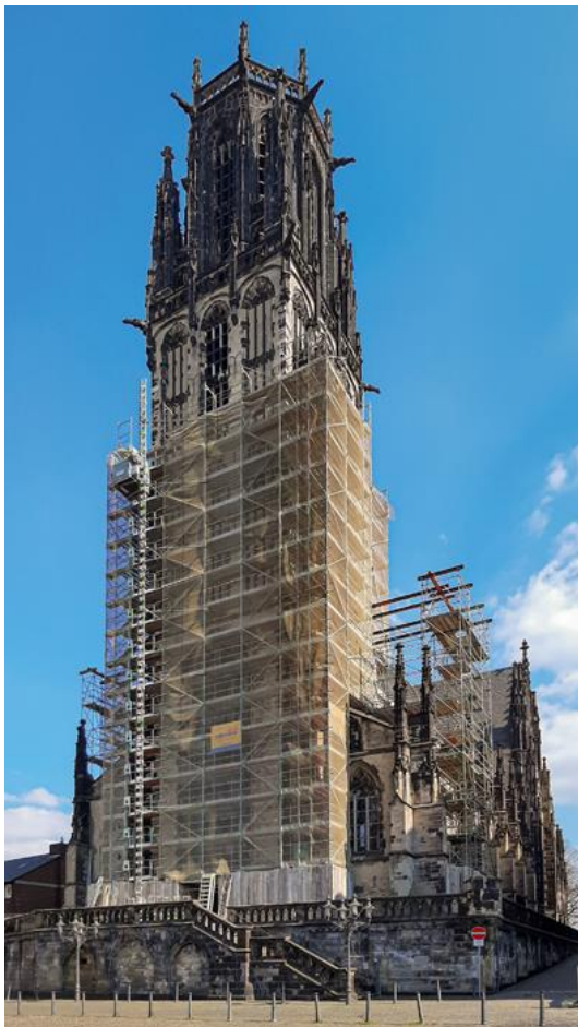
ABBILDUNG 1: DER TURM DER SALVATORKIRCHE WÄHREND DES ABBAUS DES GERÜSTES (FOTO: ANDREAS FRÄNZER, ARCHITEKTURBÜRO UBBENHORST UND PARTNER)
